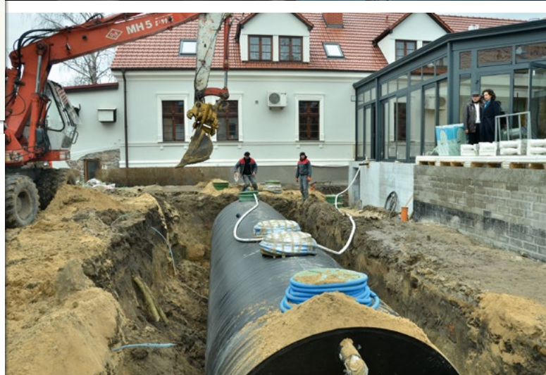
Oczyszczalnia zainstalowana dla dworku „Róża Poraja” pod ogródkiem kawowym
